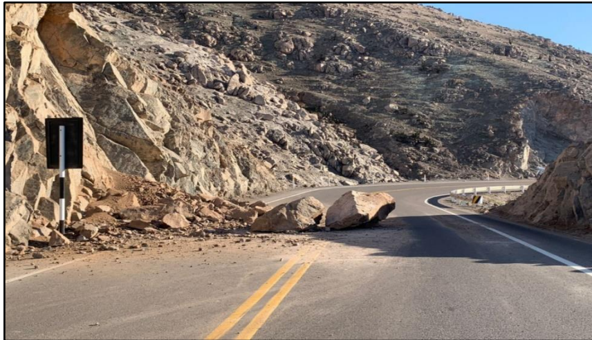
Fuente: Prensa Regional. Nota periodística: “Caída de rocas bloquea carretera Matarani - Arequipa” del 01 de setiembre del 2021
